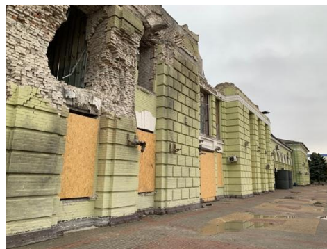
б) зруйнована будівля вокзалу у 2025 р.
